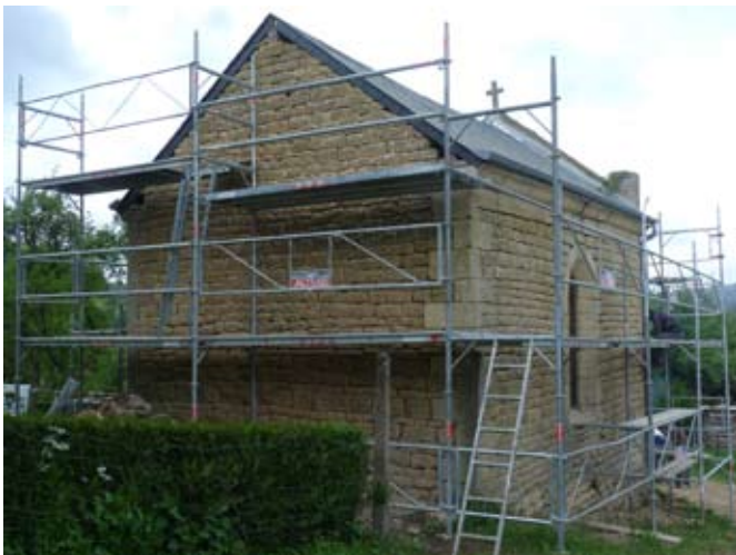
Les travaux de restauration de la chapelle St Walfroy exécutés par la CAPEB (association de jeunes en réinsertion )
